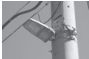
LED化している防犯街灯
