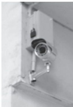
JR酒々井駅自由通路に設置されている防犯カメラ
