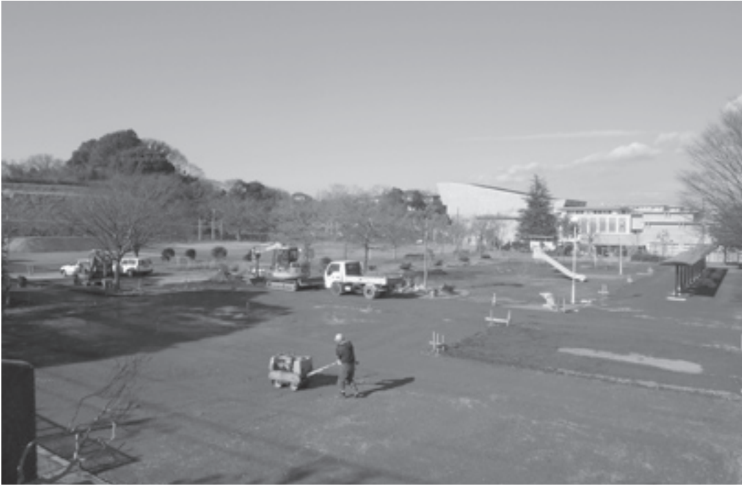
中央台公園（中央公民館・保健センター隣）を平成25年度までに医療や物資輸送のためのヘリポート、災害物資の一時保管場所、応急救護活動を行うテントや非常用トイレなど防災設備を備えた基点避難場所として再整備を行っています。
