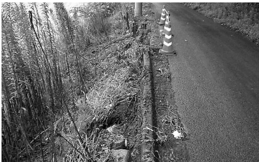
豪雨により路肩が崩れ落ちた町道 = 柏木地先=
