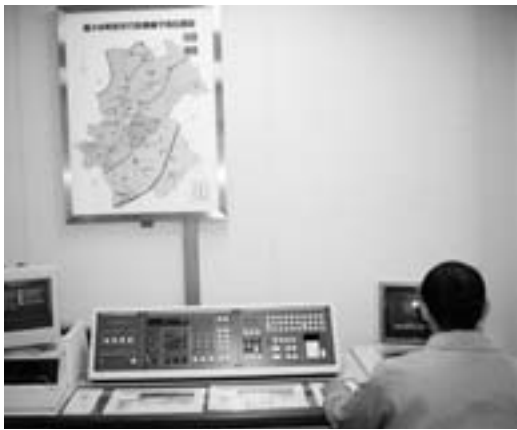
役場内に設置されている防災行政無線室
