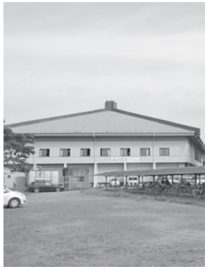
屋根の改修が求められている 酒々井中学校体育館
