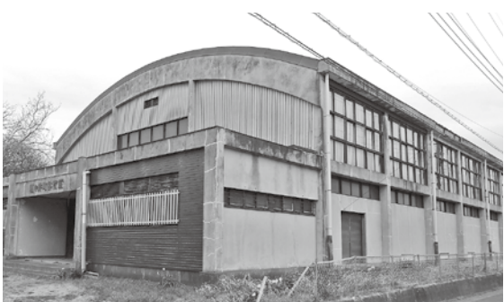
老朽化により現在使用を禁止している町体育館
