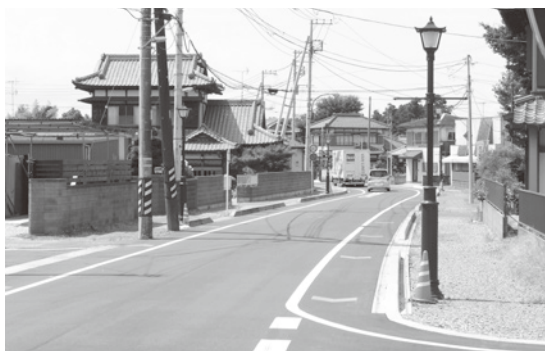
虚偽の工事完了報告を行った 町道02-009号線 (歩道整備・無電柱化工事)
