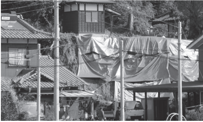
上岩橋の上郷地区で発生した土砂崩れ
