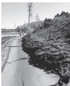
土砂の被害を受けた町道
